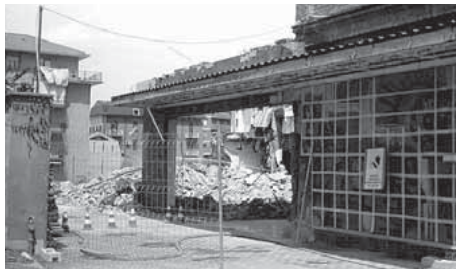
VALENZA - I lavori di demolizione in via Melgara dell'edificio che ospitava il Dancing Valentia
