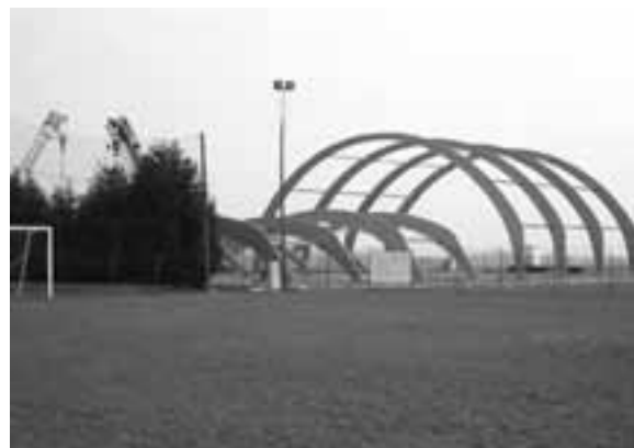
Lavori agli impianti sportivi: presto verrà ultimata la copertura del campo da calcio
