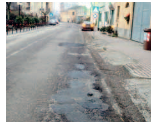
Fubine, un tratto di corso Aldo Porro. L'asfalto è 'saltato'
