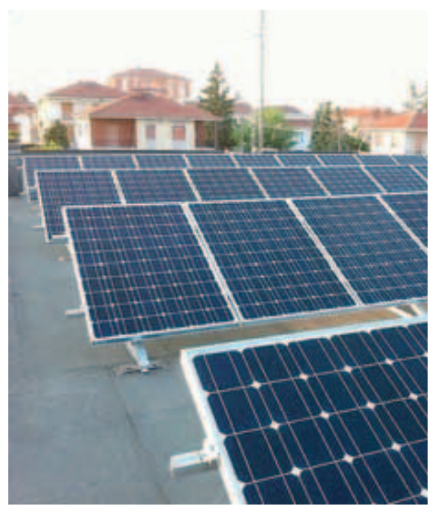
Fotovoltaico per la Croce Verde di Felizzano
